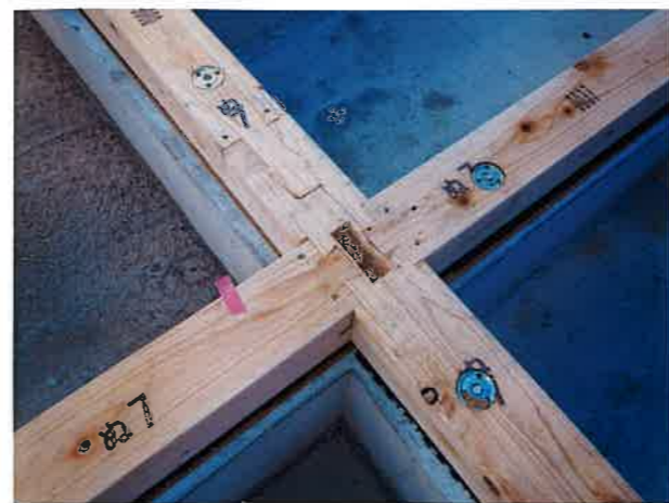
左下の土台の端部にアンカーボルトが施工されていません。土台の端部はアンカーボルトで基礎と緊結するよう建築基準法に記載されています。アンカーボルトの設置箇所を十分チェックする必要があります。
