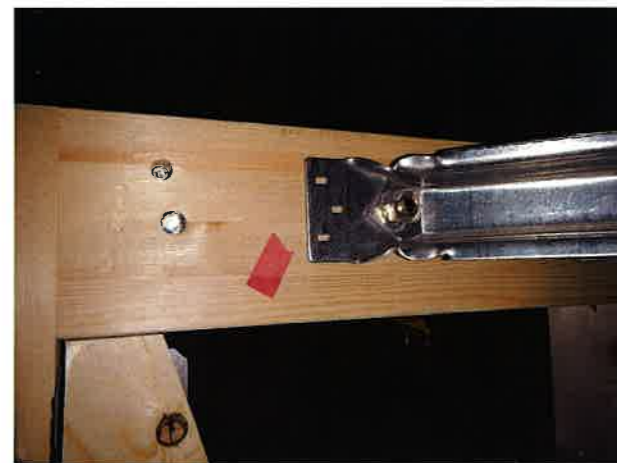
火打ち金物のボルトやナットは適切に施工されていますが、釘の打ち忘れがあります。このような金物はメーカーが指定した取付方法で施工をしないと規定の強度を発揮できない場合があります。たかが釘 1 本、されど釘 1 本。
