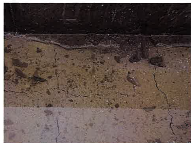
基礎出来型検査時にスラブ（基礎の床面）を撮影した写真です。よく見るとコンクリート表面にクラックが入っている箇所があります。コンクリート打設の際はクラックが発生しないよう配慮が必要となります。
