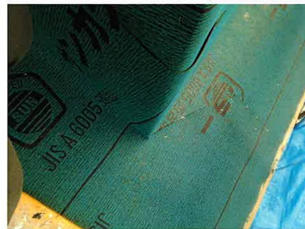
屋根ルーフィング三面交点の止水処理が未施工の写真です。三点交点（特に出隅部）はピンホールが必ずできます。雨漏り危険ポイント箇所の一つです。防水テープなどでしっかり止水処理する必要があります。
