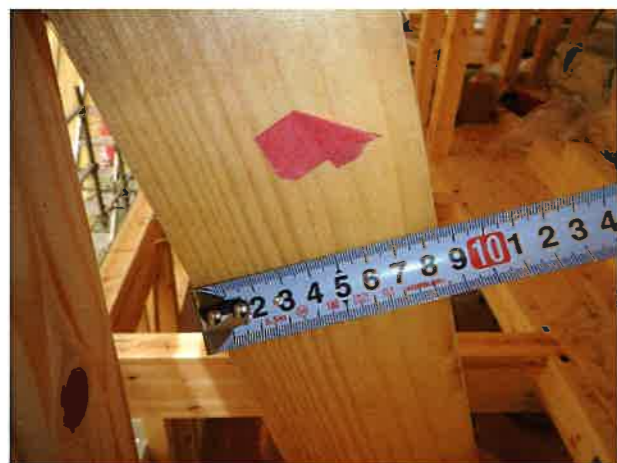
厚さ 45 ミリ、幅 90 ミリのスジカキを使用するよう図面に記載されている建物なのですが、厚さ 45 ミリ、幅 85 ミリ程度の物が施工されています。設計図書と相違すると建物の強度が変わってしまい危険です。
