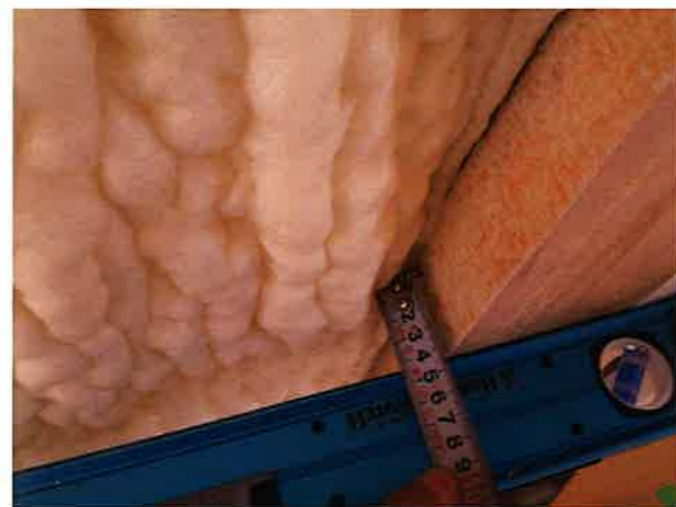
この物件の断熱材は、発泡ウレタンといわれる材料で、建築現場でウレタンの原料を吹き付け発泡させるものです。設計指示では 80 ミリのところ 60 ミリ程度しかなく、厚さが不足しています。
